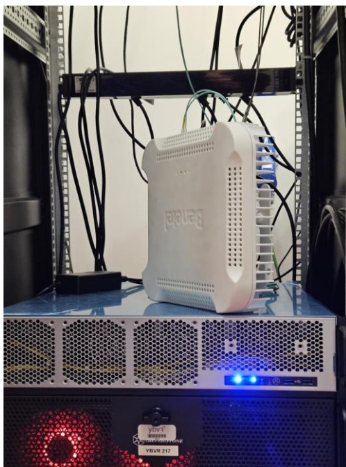
Figura 8 – O-RU RAN550 instalada en la sala de servidores.
